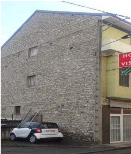
Construction récente (2 e moitié du XX e siècle) moellons de pierre hourdés, planchers et dalles en blocs béton.
