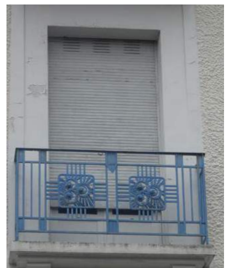
Porte-fenêtre, volets roulants en bois, encadrement et modénature béton moulé, balcon ferronnerie à motifs Art-déco.
