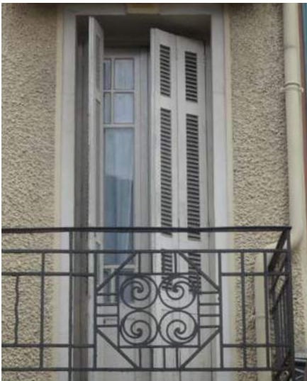
Porte-fenêtre, partition du vitrage type années 1930, volets pliants en bois persiennés, balcon ferronnerie à motifs Art-déco.
