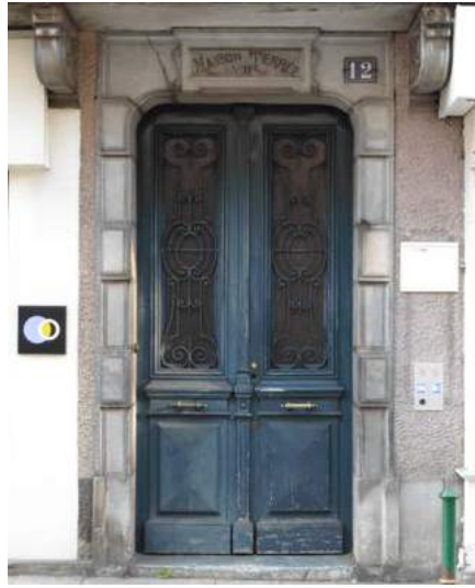
Porte à vantail double, panneaux de bois pleins et vitrés, grille de protection en fer forgé.
