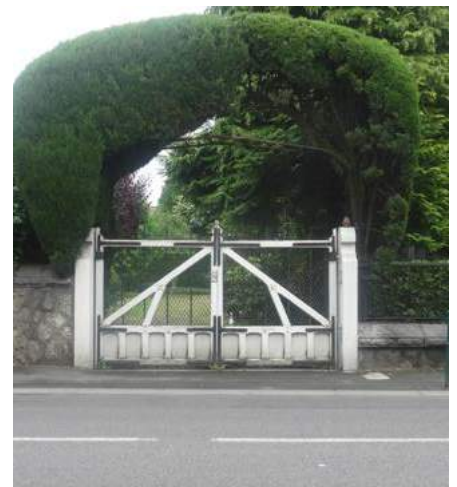
Le portail en bois peint surmonté d'un arc formé par le résineux.
