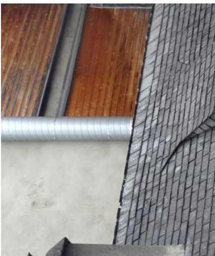
Toiture à croupe, couverture ardoise, houteau de ventilation, lucarne à croupe «capucine».
